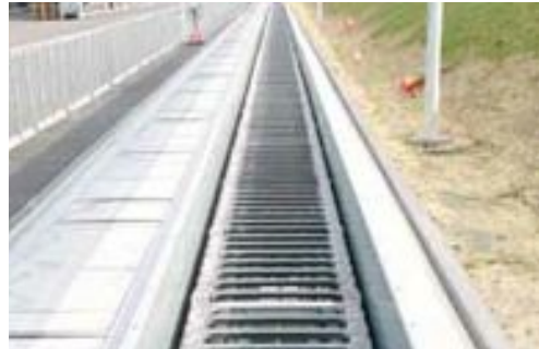
P4.56: Dauertest im igus®-Außenversuch - Verfahrweg 120 m P4.56: igus® outdoor test set up - travel length 120 m
