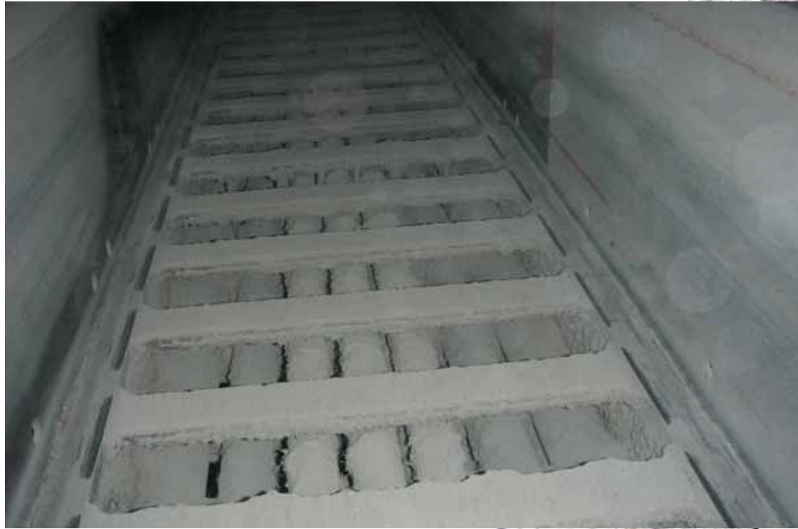
High reliability in refuse incineration plant Sicherer Einsatz in Müllverbrennungsanlage
