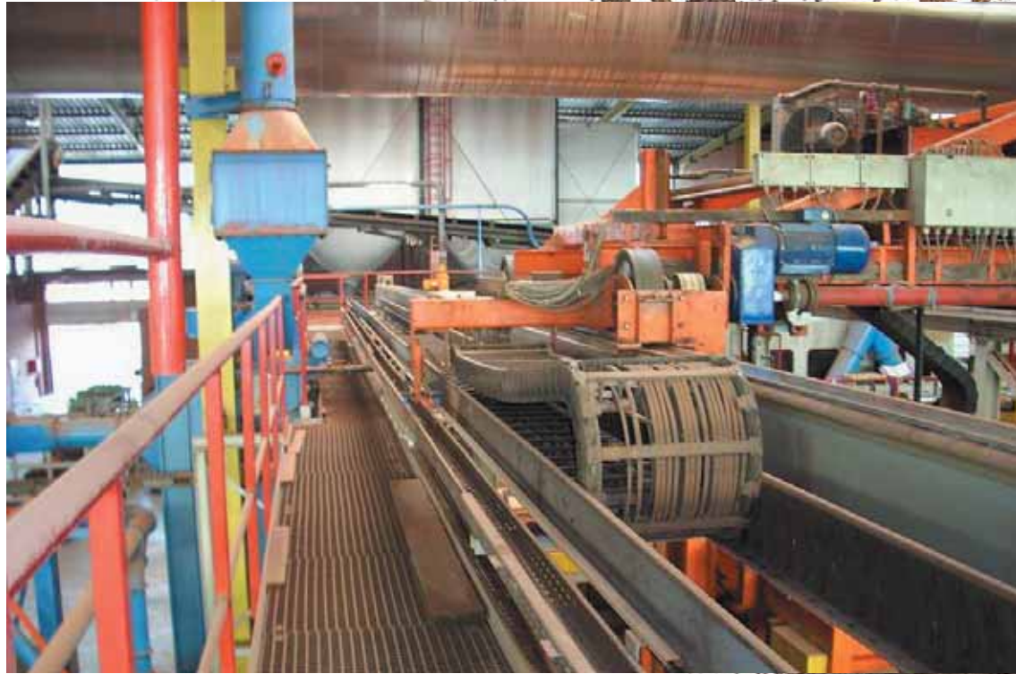
Very demanding industry due to brick dust in the environment. Höchste Beanspruchung durch Ziegelstaub in der Baustoffindustrie
