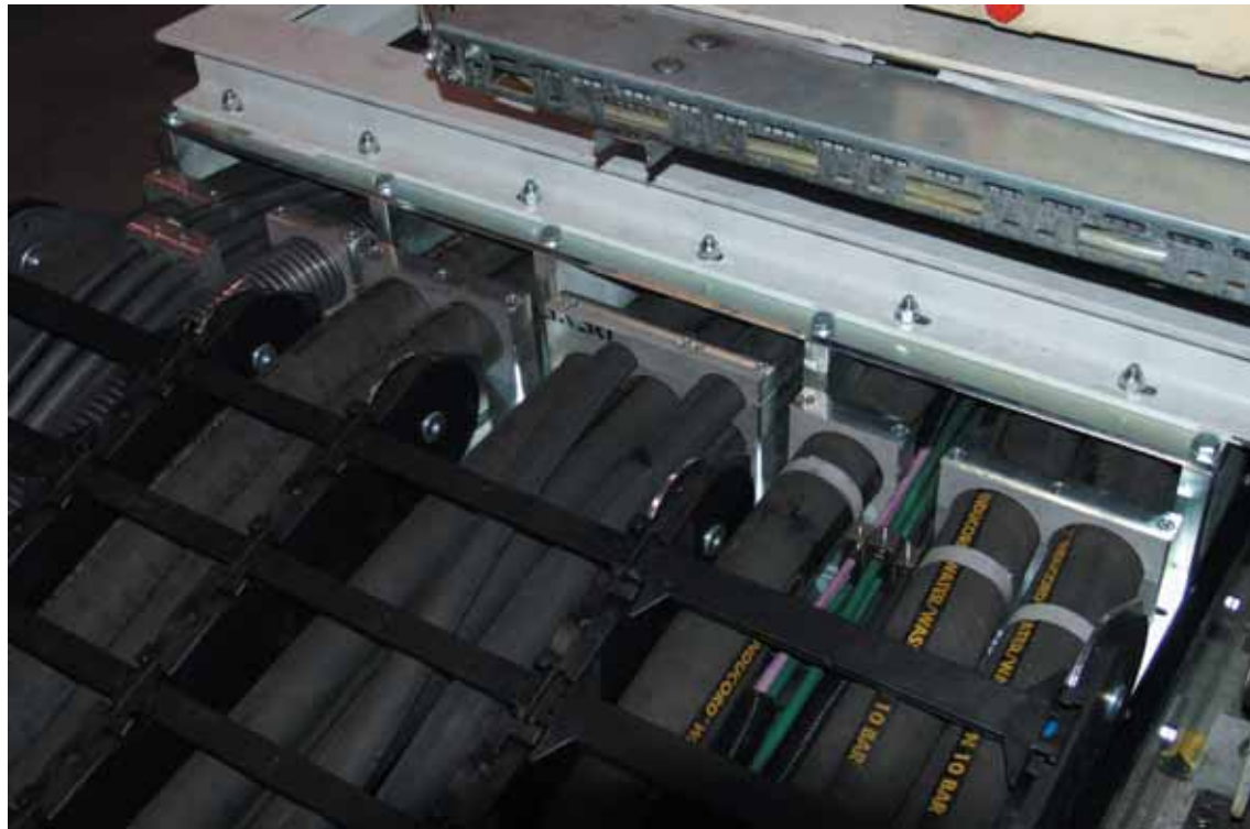
High additional load due to high number of hoses and cables Hohe Zusatzlasten durch Schläuche und Kabel
