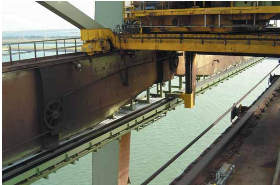
Completely harnessed system on a ship unloader Konfektioniertes System an einem Schiffsentlader
