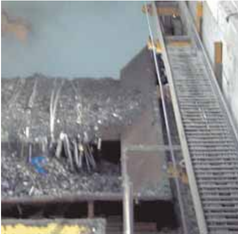
Austria, Niklasdorf, ABV, district heating plant Österreich, Niklasdorf, ABV, Fernwärmanlage
