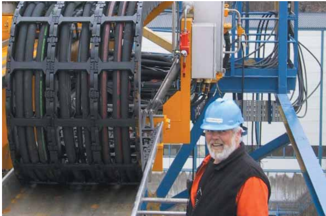
High additional loads in challenging offshore environments Hohe Befüllungsgrade im anspruchsvollen Offshore-Bereich
